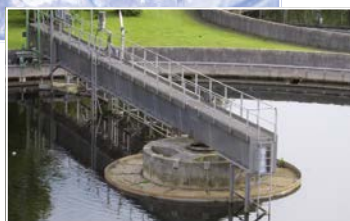
Traitement des eaux usées
